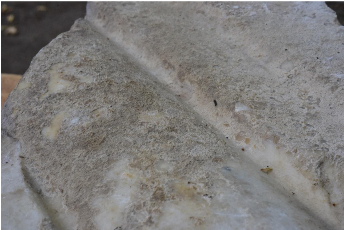
Fot. 13 Fragment oprawy schodów ambony, nawarstwienia węglanowe, zbliżenie. Stan 2024
